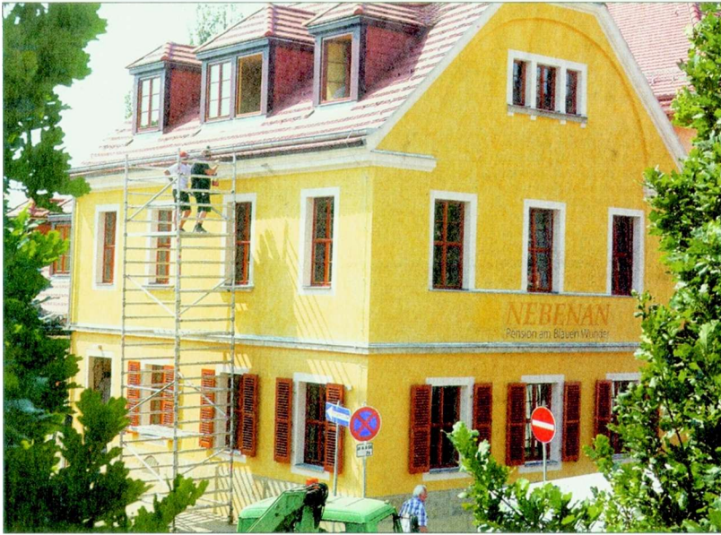
Die leuchtend gelbe Fassade des sanierten Hauses aus dem 18. Jahrhundert wurde dem historischen Umfeld des Schillerplatzes angeglichen. Fotos: Steffen Unger
